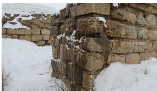
شکل ۱۳. از بالا به پایین تصاویری از یخبندان و هوازدگی سنگ‌ها ناشی از نزولات جوی بر روی دیوارها (عوارض این مشکلات شامل تورم و پوسته‌شدن سنگ‌ها)، (عکس‌ها از آرشیو پایگاه تخت سلیمان)
