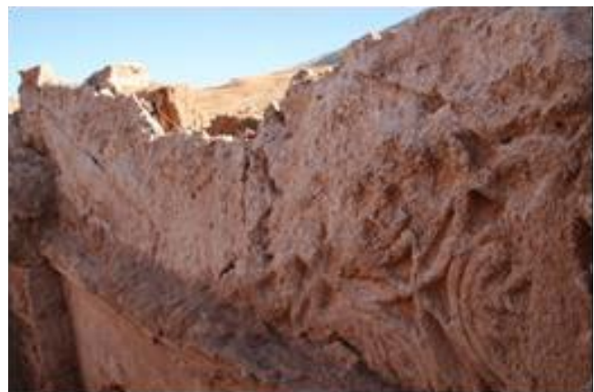
شکل ۸. فرسایش شدید سطح آرایه های گچ بری در اثر عوامل محیطی و مراحل تزریق پریمال و گچ در میان ترک ها به منظور استحکام بخشی Figure 8. Severe surface erosion of the plaster reliefs caused by environmental factors and the subsequent injection of Primal and plaster into the cracks for consolidation.
